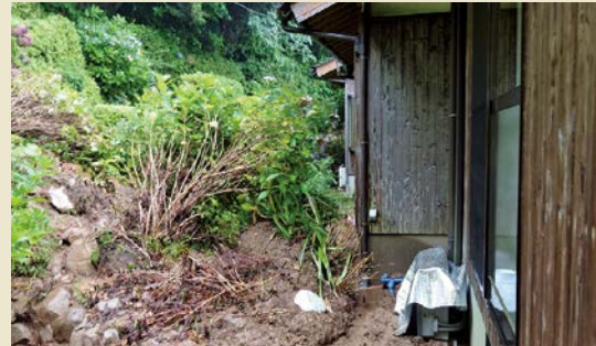
本堂裏山の崩落／宇部北組 浄円寺
