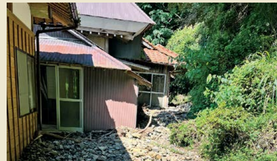
境内地内への土砂流入／豊田組 千秀寺
